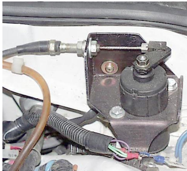
Fig. 17– Aspecto do potenciômetro e suporte de fixação.
